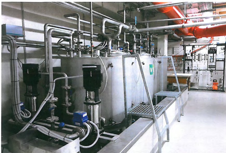
Nádrže kapalných radioaktivních odpadů
